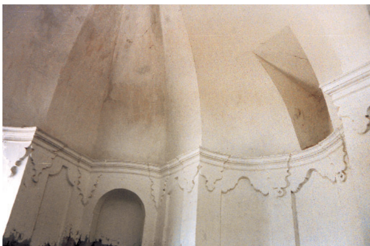
Fig. 12. FRAY ANTONIO DE SAN JOSÉ. Vista interior del camarín de la Virgen de la Vega; la ondulación del muro presenta numerosos puntos de conexión con el templo de Sant'Ivo, tal y como se comprueba en las Figs. 15 y 16.
