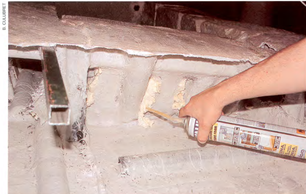
II. Macizado del umbral de la puerta de acceso con espuma de poliuretano.
