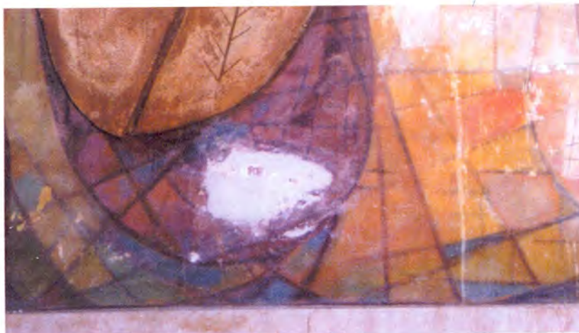
Detalle. Antes de la restauración, donde se evidencia la ubicación de una fuente de luz debido a la reacción del estrato superficial de yeso que la sellaba con la humedad de filtración.
