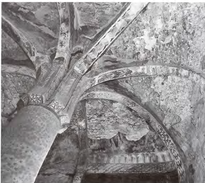
1. Interior de la ermita de San Baudelio de Berlanga (Soria), vista del estado de conservación de la "bóveda de palmera" en el año 1964. Se puede observar la pérdida de la decoración de los elementos que ha dejado al descubierto el sistema constructivo de mampostería con lajas de toba calcárea.
