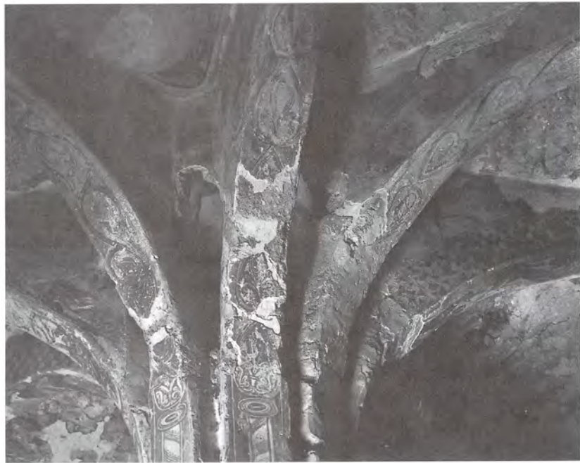
2. Detalle del estado de conservación de la decoración pictórica en 1964. Se aprecian importantes grietas y separaciones del soporte pictórico, así como pérdidas de policromía.
