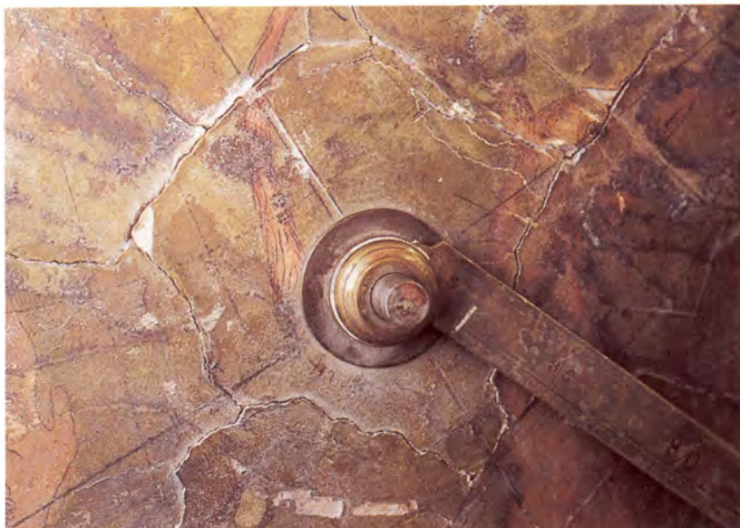
Polo Sur. Estado inicial. Levantamiento de estuco, grietas y zonas perdidas.
