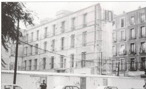
Foto 1.- Desgraciadamente se ha generalizado la eliminación de las estructuras de los edificios antiguos conservando sólo la fachada.
