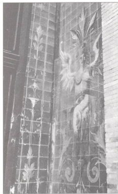
Estado inicial. Desprendimiento de azulejos en el panel derecho. Refuerzo de metacrilato.
