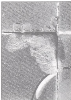
Estado inicial. Azulejos fragmentados. Rejuntado defectuoso.
