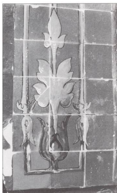
Estado inicial. Repintes y reintegraciones en escayola pintada. Rejuntado defectuoso. Abombamientos y desplomes.
