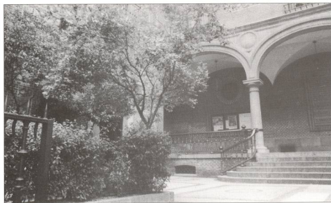
Foto 7.-La humedad proveniente de claustros y otros espacios ajardinados penetra por capilaridad en los muros del edificio.
