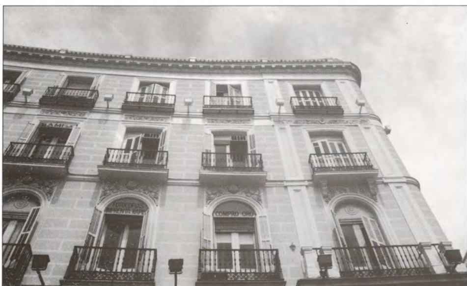
Foto 6.- El empleo de pinturas plásticas en frisos, cornisas y elementos decorativos al aire libre conlleva graves problemas de humedad para el edificio.
