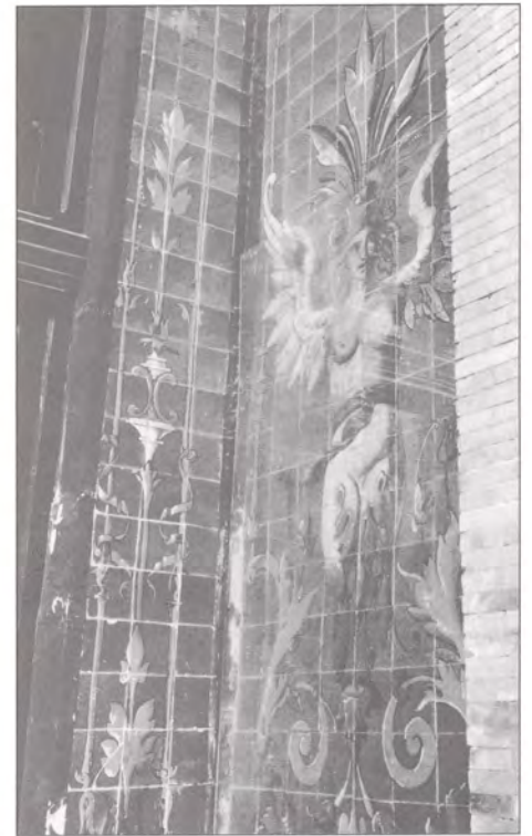
Estado inicial. Desprendimiento de azulejos en el panel derecho. Refuerzo de metacrilato.
