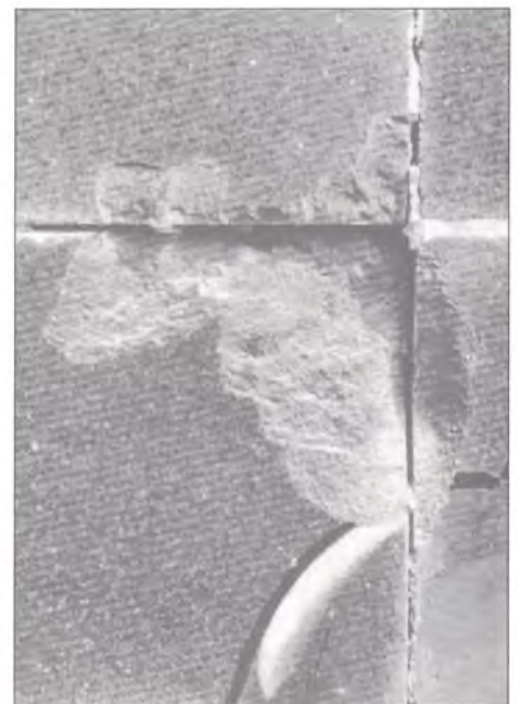
Estado inicial. Azulejos fragmentados. Rejuntado defectuoso.
