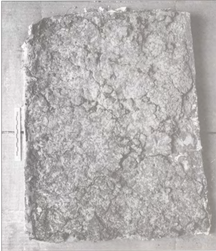
Foto 4.- Estado del reverso antes de la realización del soporte.
