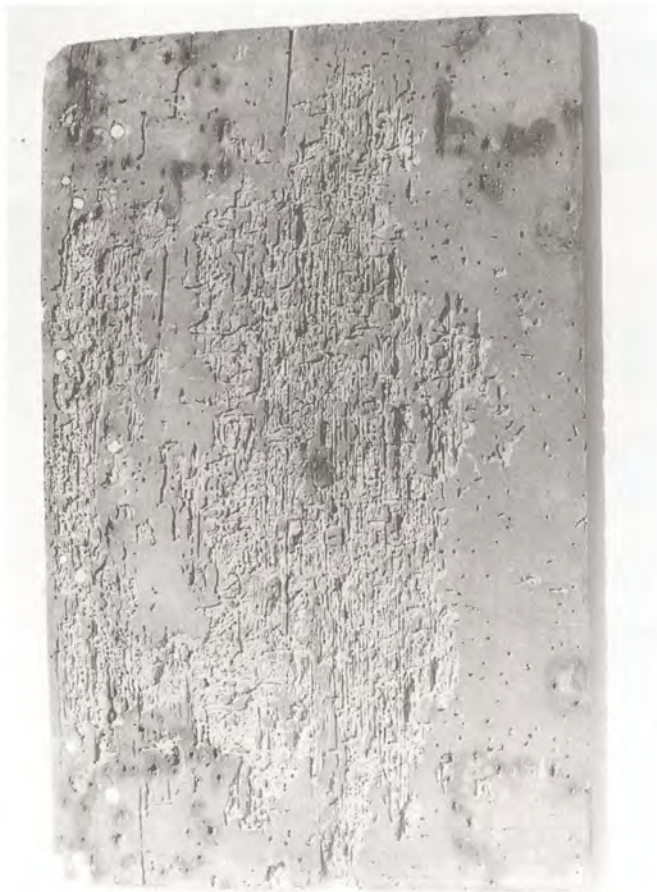
Galerías producidas por la carcoma en la madera de la cubierta.
