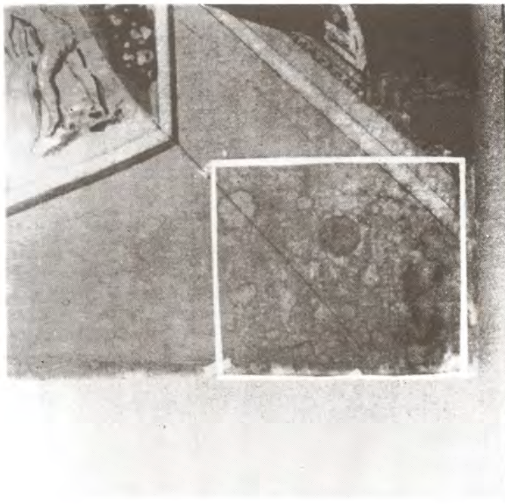
Detalle de una de las esquinas donde se aprecian cercos de humedad.
